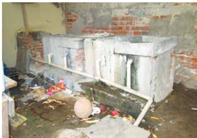
En el destrozado lavadero, como pueden, limpian su ropa.
