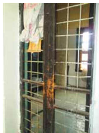
Un drenaje colapsado es un foco de infección para los jóvenes, quienes viven en un sitio a todas luces deprimente. En la gráfica: la puerta de entrada de una de las habitaciones de los hombres.
