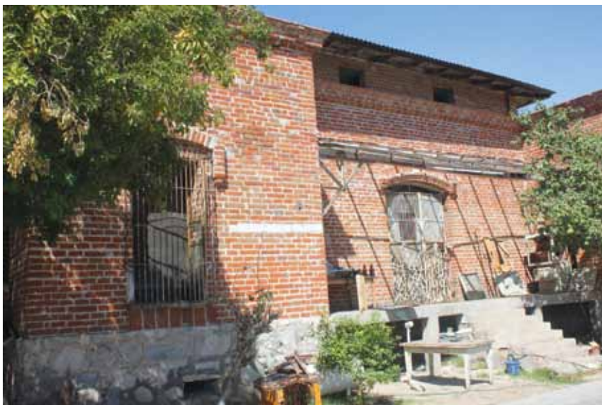
En condiciones críticas por la falta de mantenimiento se encuentra la Casa del Estudiante Empalmense, ubicada en la Colonia Centenario. Si el exterior luce abandonado... el interior está en peores condiciones.
